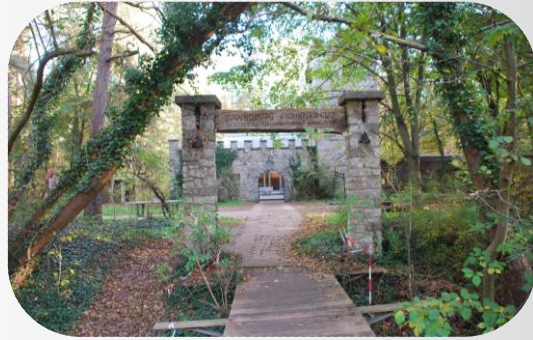
Die marode Zugbrücke.
