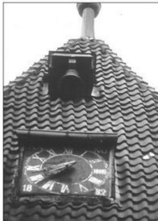
1986 Die neue Glocke von 1986, die die Stunden anschlägt, hängt an der Südseite über dem Zifferblatt der Uhr.
