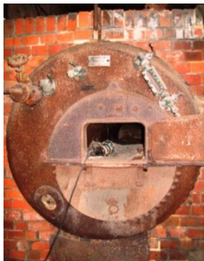
Klappe des Kohlekessels in der Brelinger Brennerei.
