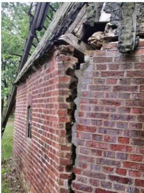
Der bauliche Zustand der Windmühle ist äußerst besorgniserregend.
