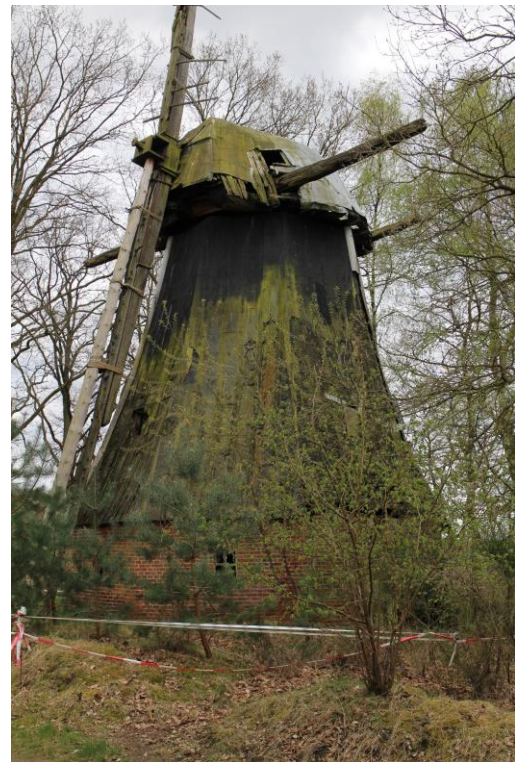
Die Windmühle mit abgestützten Flügeln bei insgesamt recht desolatem Eindruck.
